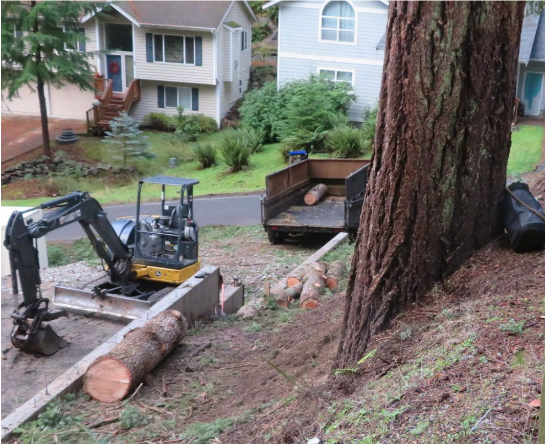
Fotografía 5. Escena del incidente, con la sección de 330 libras en el fondo del terraplén por el que cayó el trabajador.
