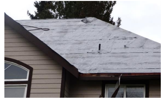
Fotografía del techo donde el trabajador se cayó.
