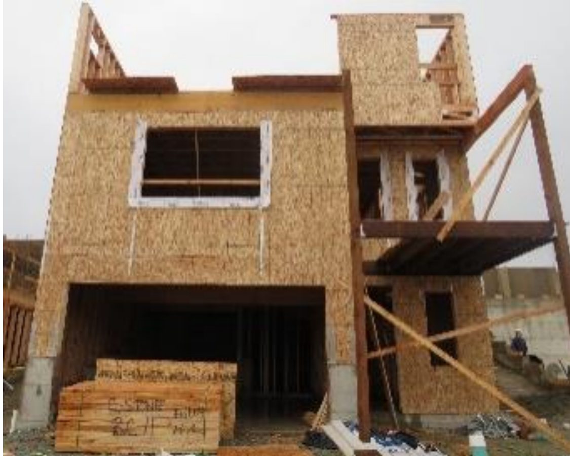
Fotografía 1. Piso superior sin paredes del que se retiraron los barandales.
