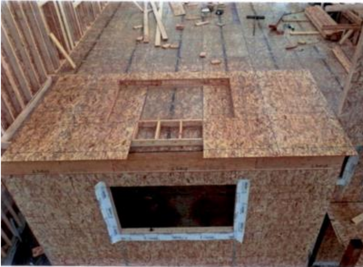
Fotografía 2. Suelo sin protección en donde cayó el instalador de estructuras.
