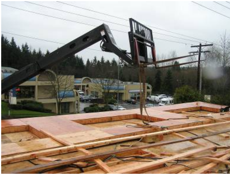
Foto: Esta fotografía muestra la pared que se cayó y el montacargas con la eslinga de nylon amarrada, después del incidente.
