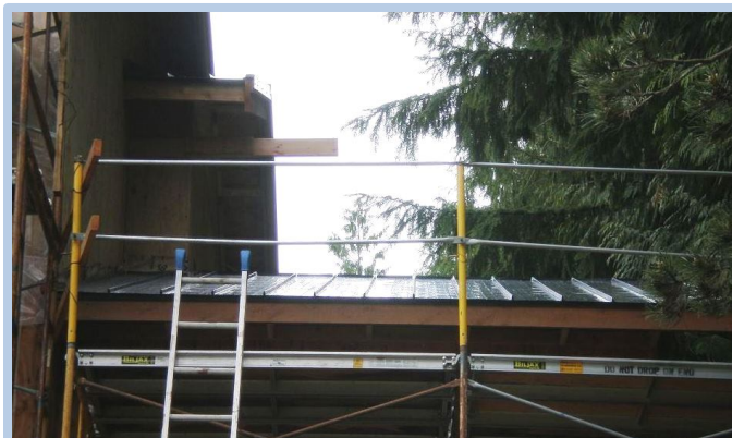
Fotografía de la escena del incidente mostrando el techo de metal del cual resbaló el techador y la plataforma del andamio de donde luego cayó y finalmente cayó 20 pies al suelo.
