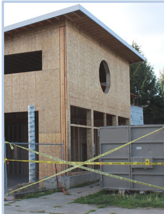
La escena del incidente muestra la ubicación donde un contratista de techos que no estaba usando protección contra caídas cayó del techo de una iglesia desde 25 pies de altura hacia una acera de concreto.
