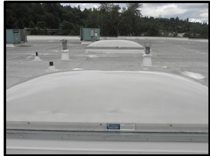
Tragaluz similar por el que cayó la víctima, ubicado en el techo en el que estaba trabajando.
