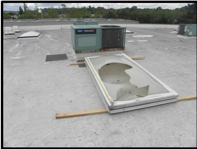
Después del accidente, se sacó el panel del tragaluz.
