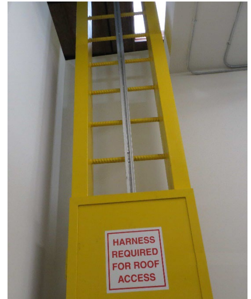
Punto de acceso de la escalera de mano fija usada para llegar al piso del almacén. En el momento del accidente no había un letrero que indicara que se requería protección contra caídas para usar la escalera.
