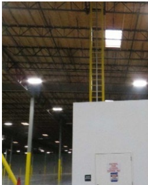
Escalera de mano fija para acceso al techo en el interior del almacén.
