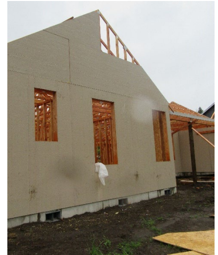
Costado de la casa en donde el instalador de estructuras colocó la escalera de extensión sobre tierra suave. Mientras subía, esta se deslizó y el trabajador cayó ocho pies.
