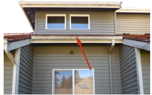
Рисунок 1. Красная стрелка указывает на край крыши, с которой упал бригадир, перемещая материалы.
