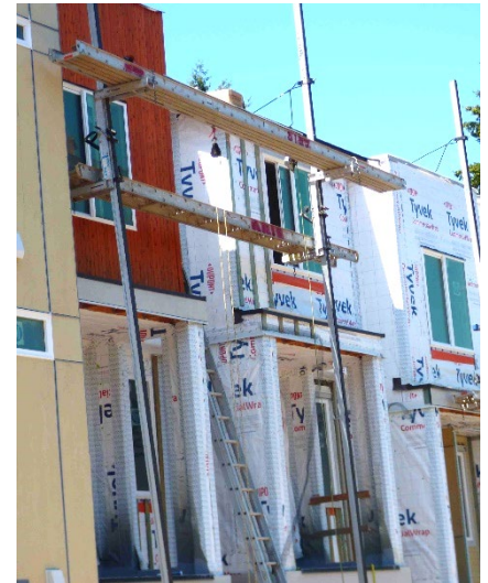
Andamio de palometa de gato sin barandillas desde el que el instalador de paneles laterales cayó 23 pies.
