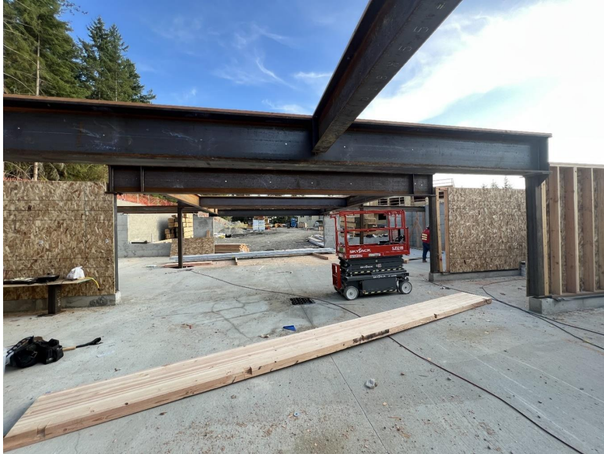
Fotografía 4. Viga de madera caída y segundo elevador en el sitio del incidente.
