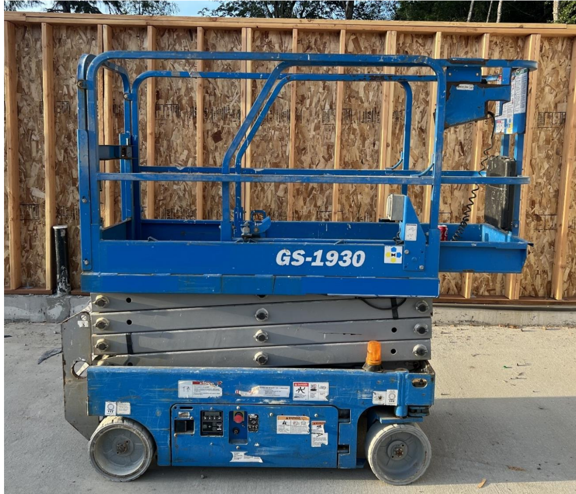
Fotografía 1. Elevador de tijera que fue parte del incidente.
