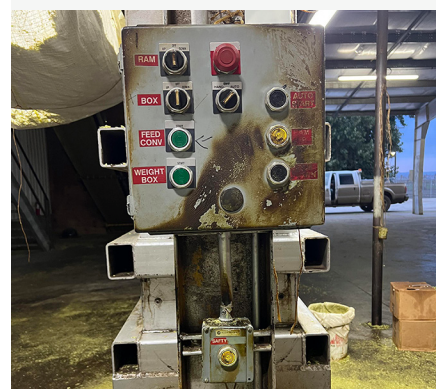
Panel de control situado a un lado de la embaladora de lúpulo.
