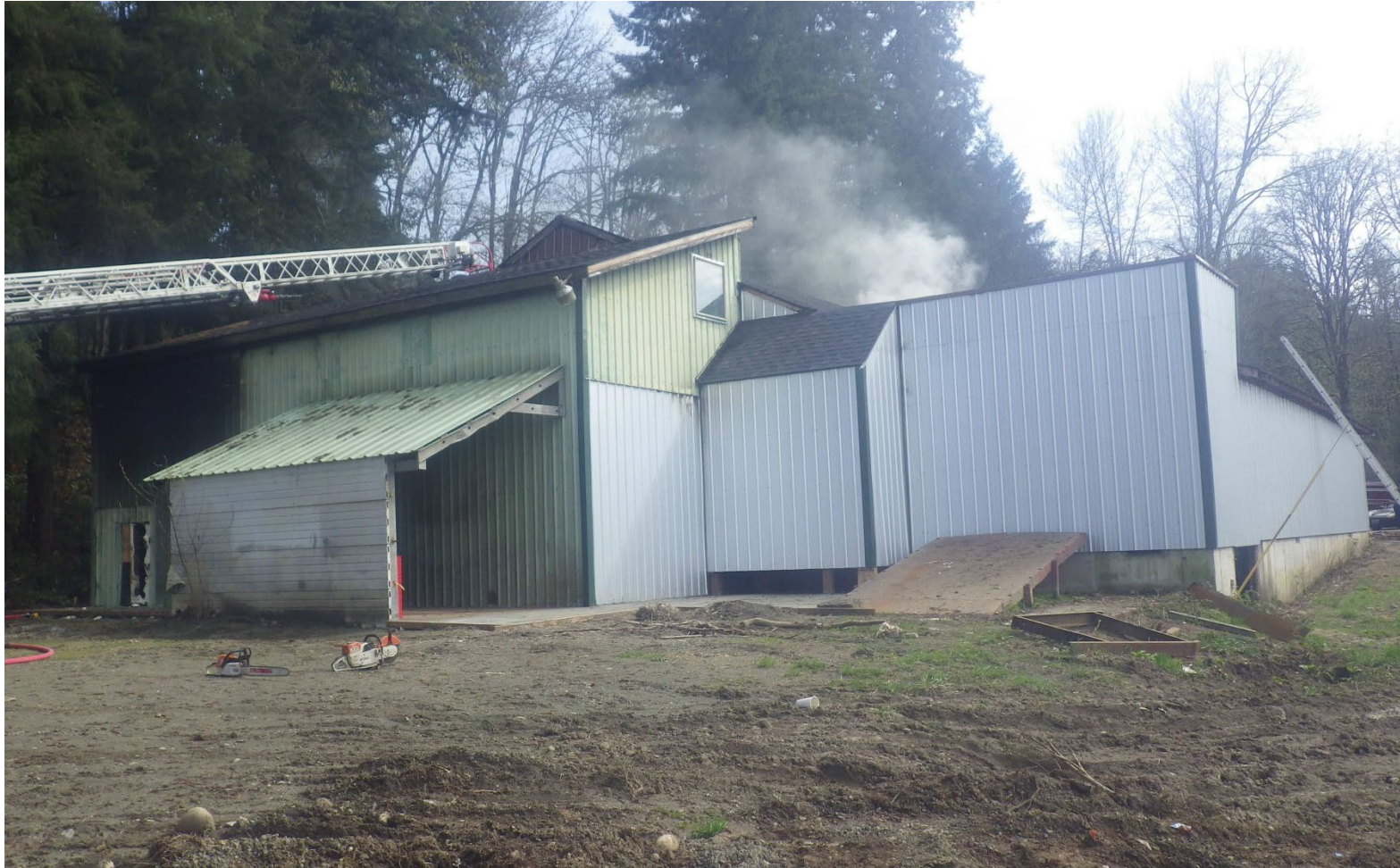
Fotografía 5. Edificio después de la explosión.
