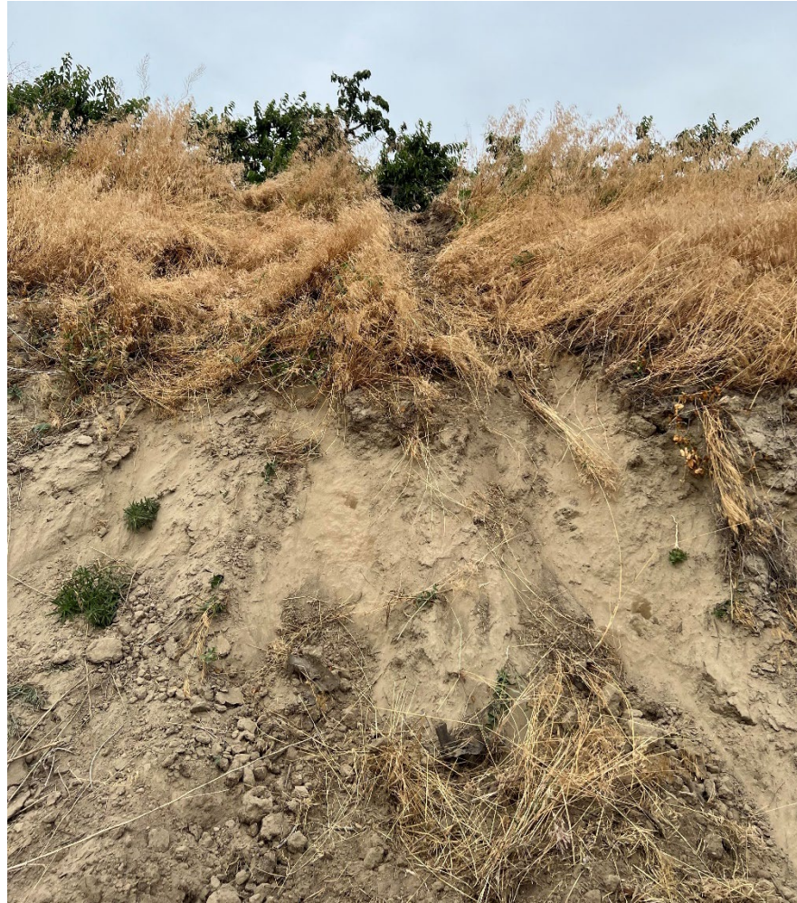
Fotografía 3. Lado del terraplén en el que se volcó el tractor.
